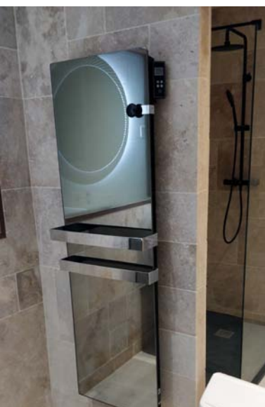
Renovatioun à la Bridderhaus: Buedzëmmerheizung, Wert ca. 3.000€ am Bâtiment 4.
